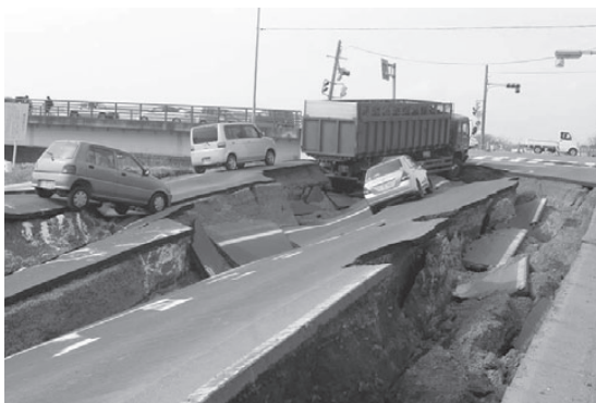
大崎市内の被害の状況
